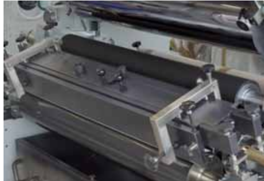
Beschickungskasten für den Auftrag von Hotmelt aus dem Spalt
